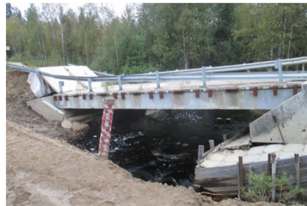
Рисунок 1 Аварийная ситуация на мосту
