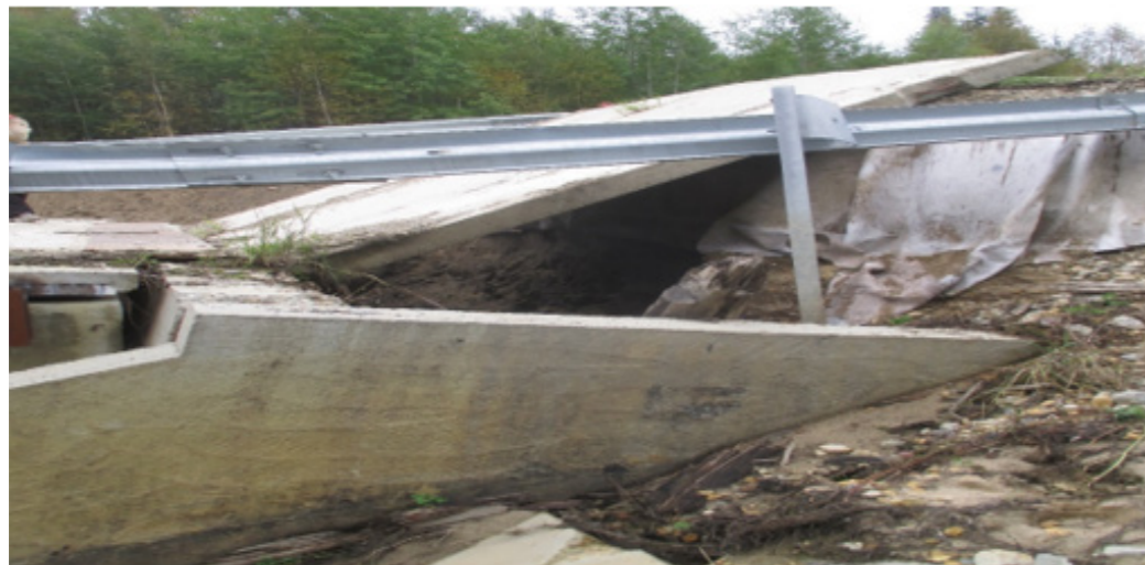
Рисунок 2. Вымывание основание за диванным устоем и подходной плитой моста. Отсутствие гидроизоляционной пропитки.
